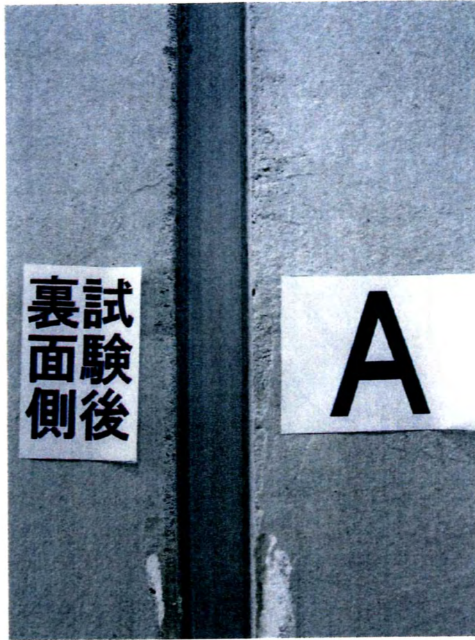
写真-15 試験後の鉛直スリット部（裏面側，屋内側）の状況 （試験体記号A）
