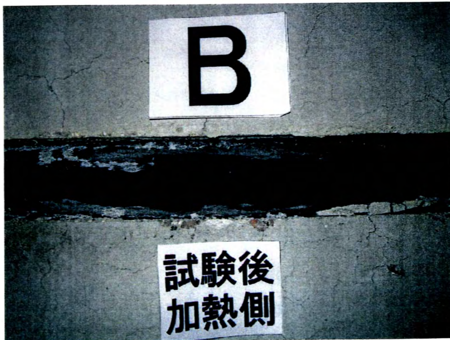
写真-18 試験後の水平スリット部（加熱側，屋内側）の状況 （試験体記号B）
