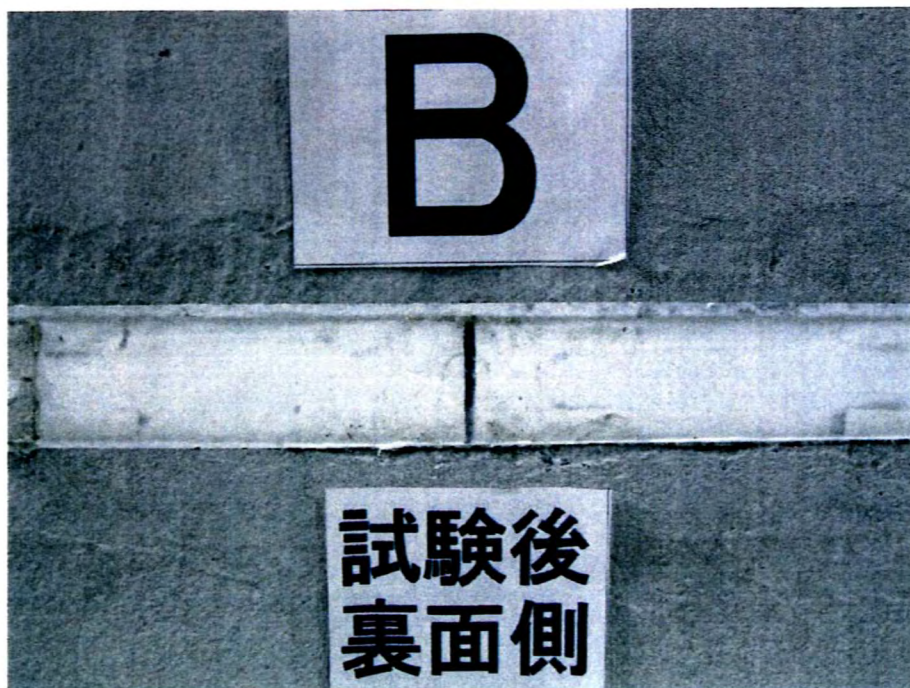
写真-20 試験後の水平スリット部（裏面側，屋外側）の状況 （試験体記号B）
