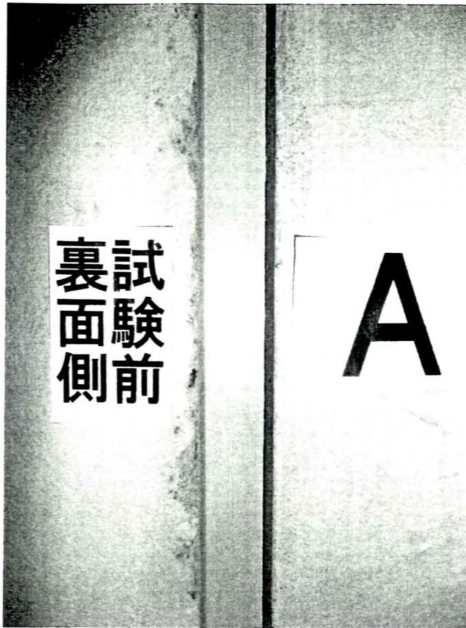
写真-5 試験前の鉛直スリット部（裏面側，屋内側）の状況 （試験体記号A）
