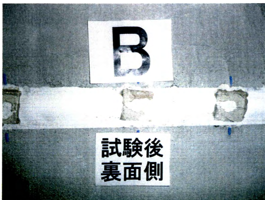
写真-20 試験後の水平スリット部（裏面側，屋外側）の状況 （試験体記号B）
