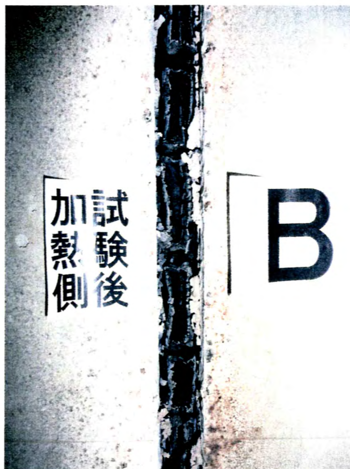
写真-17 試験後の鉛直スリット部（加熱側，屋内側）の状況 （試験体記号B）
