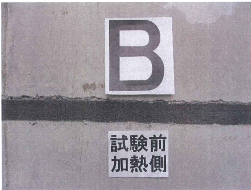
写真-8 試験前の水平スリット部（加熱側，屋内側）の状況 （試験体記号B）
