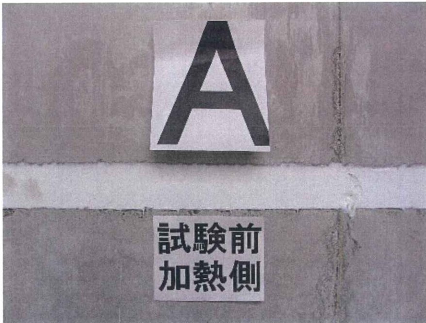
写真-4 試験前の水平スリット部（加熱側，屋外側）の状況 （試験体記号A）
