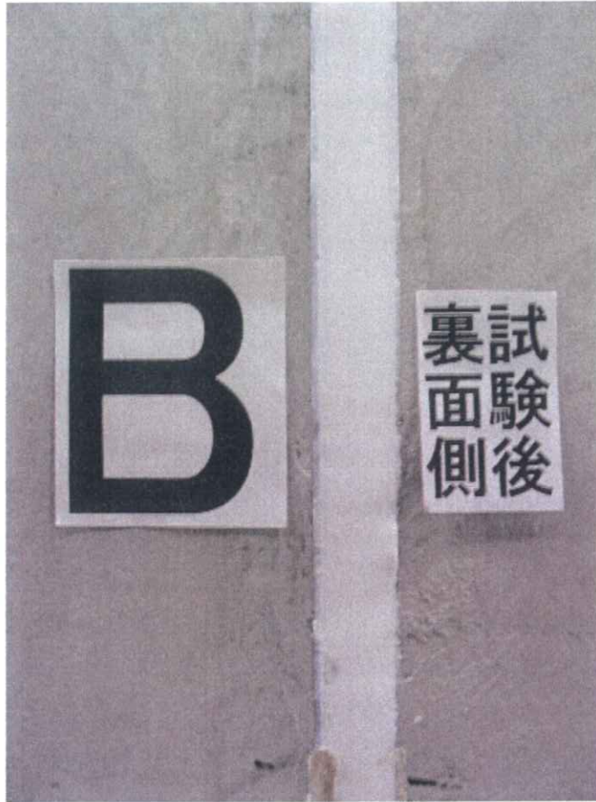
写真-19 試験後の鉛直スリット部（裏面側，屋外側）の状況 （試験体記号B）
