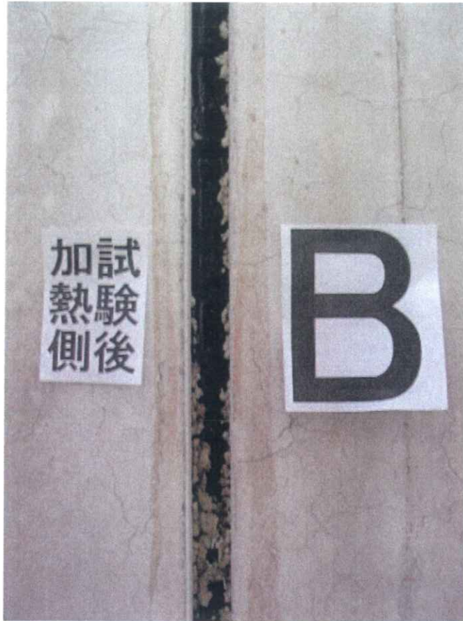
写真-17 試験後の鉛直スリット部（加熱側，屋内側）の状況 （試験体記号B）
