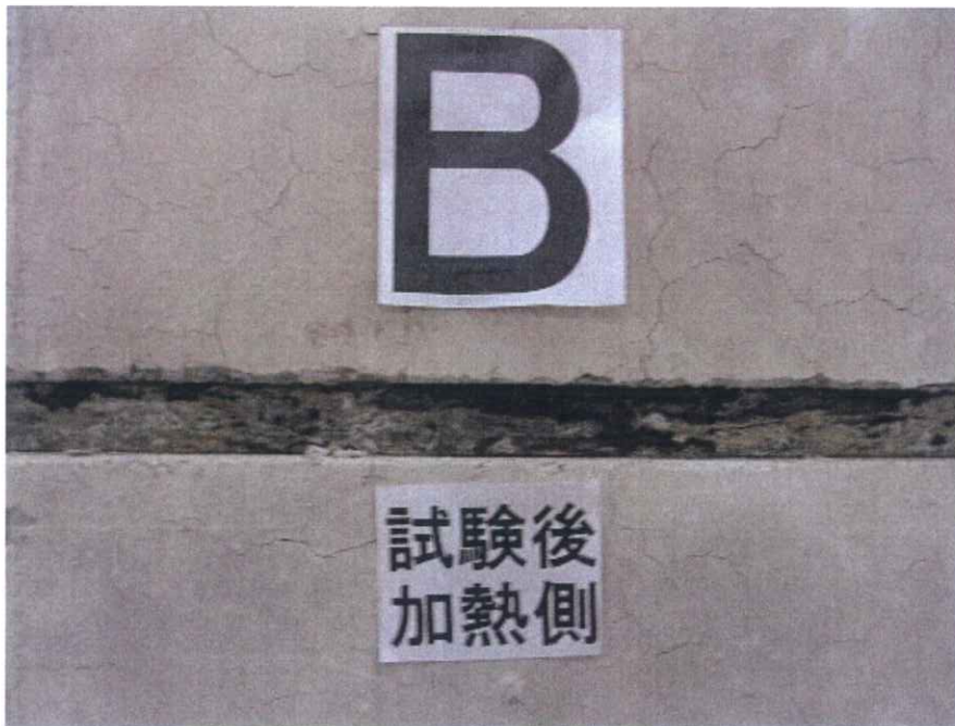
写真-18 試験後の水平スリット部（加熱側，屋内側）の状況 （試験体記号B）
