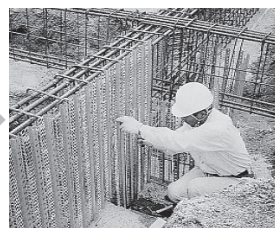
②パンチングフォーム準備 (パネル連結、曲げ加工等) ③パンチングフォーム配置
