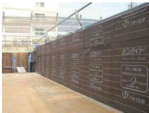
浄化センターの目地に使用
