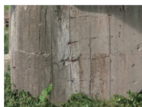
劣化した橋脚
