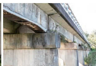
劣化した橋梁
